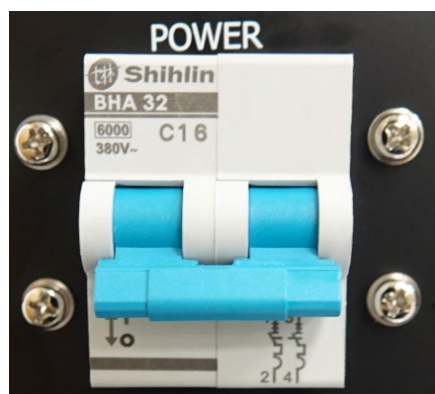
電源オフの状態
